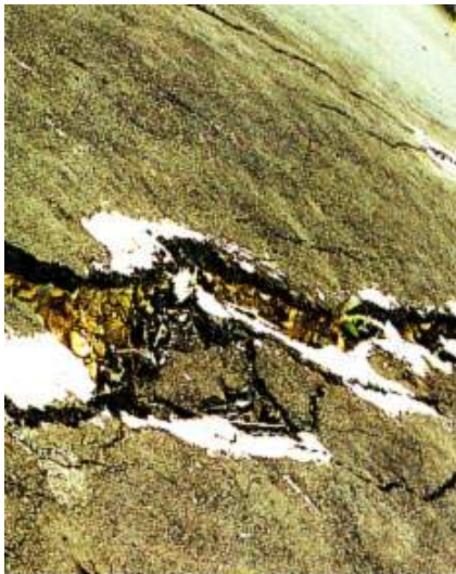
圖二：路面出現裂縫滑動的情形
