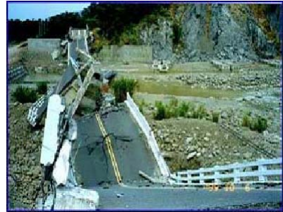
路面、橋梁斷裂
