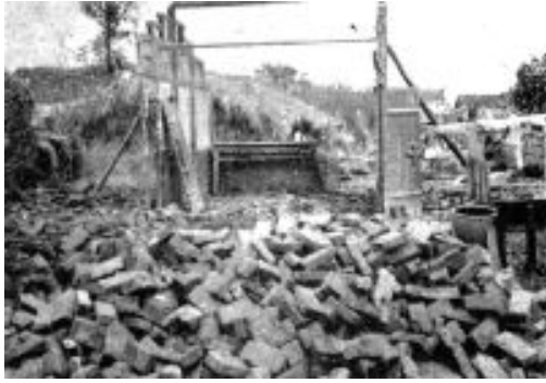
圖 13-10 永康鄉三民村 11 號陳全鐵宅(共四間)向北北西潰倒，磚、木混合建造，屋齡 10 年，向北北西攝 徐明同、呂新民攝
