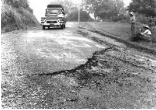
圖 13-13 關仔嶺往仙公廟入口處發生地裂，走向北北東-南南西，長 25 公尺，深度 50 公分以上，最大裂口 12 公分，向北北東攝 徐明同、呂新民攝
