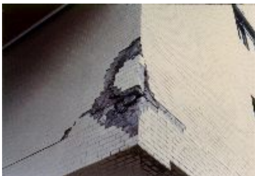
圖 13-22 飯店二樓外牆牆角之破壞 鄭世楠攝
