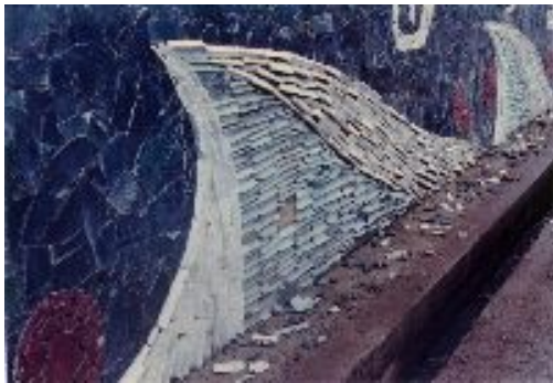
圖 13-20 花蓮市中心公園圍牆上裝飾之大理石磚掉落一地 鄭世楠攝
