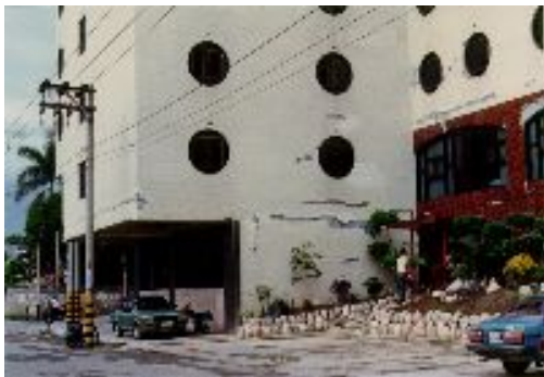
圖 13-21 花蓮市公園路某觀光飯店，牆角水泥剝落與外牆磁磚掉落 鄭世楠攝
