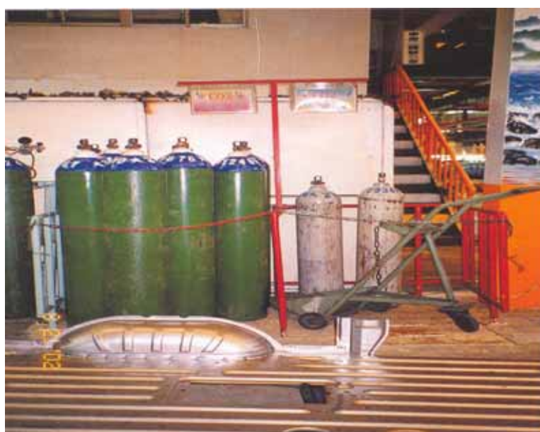
圖 6-5 高壓氣體鋼瓶已依規定標明所裝氣體之品名且妥予固定
